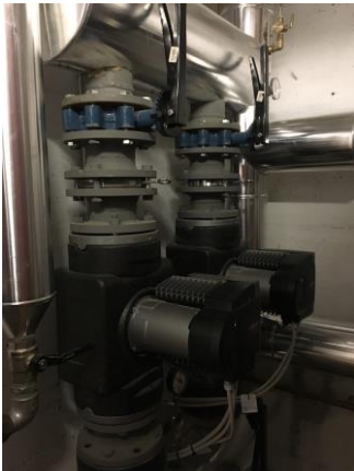
Inverter su pompe
