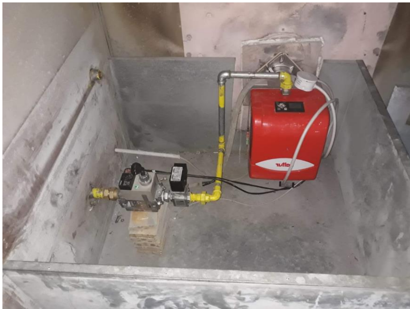
Nuovo bruciatore a metano (in sostituzione del bruciatore a gasolio)
