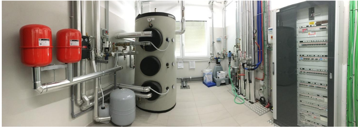
Locale tecnico - impianto Solare Termico
